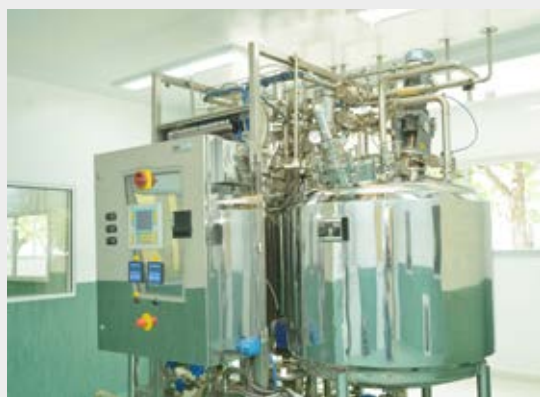
Foto 2. Sala productiva de medicamentos fármacos inyectables
